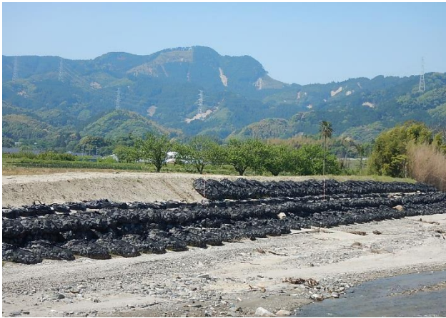
写真：赤谷川（福岡県朝倉市）九州北部豪雨（H28.7）での被災箇所（H29.4撮）
